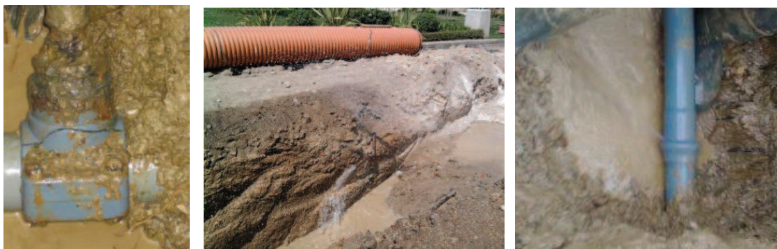
Figura 2.11 - Fugas e roturas
