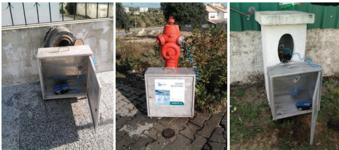
Figura 5.17 - Registadores de pressão instalados nos pontos críticos da ZMC.
