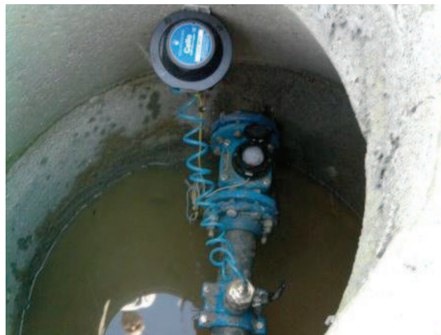
Figura 5.11 - Datalogger de caudal e pressão instalado à entrada da ZMC-2.
