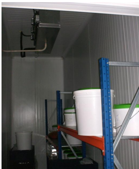
Figura 3.16: Interior da câmara de conservação 3
