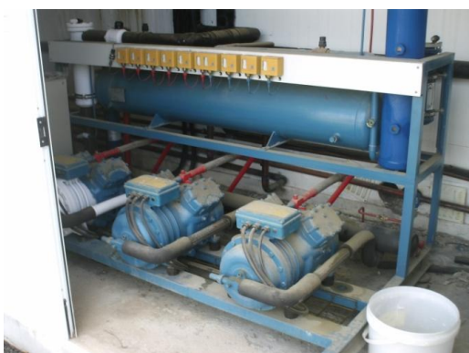
Figura 3.7: Compressores lado esquerdo 1
