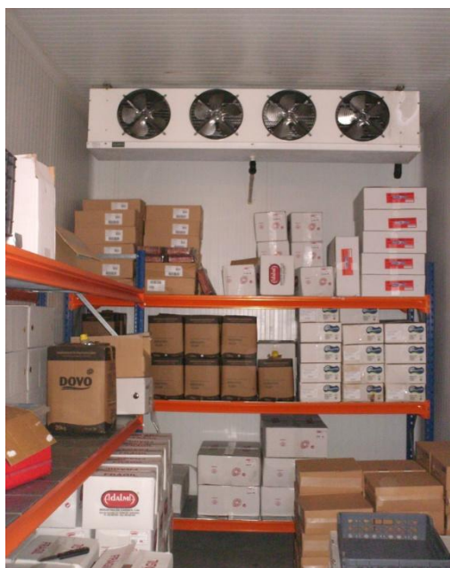
Figura 3.14: Interior da câmara de conservação 1
