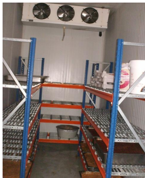
Figura 3.15: Interior da câmara de conservação 1
