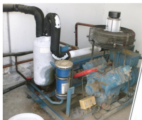
Figura 3.8: Compressores lado esquerdo 2
