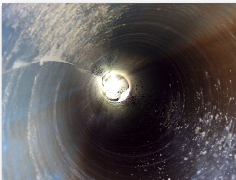
Figura 26 - Foto do interior de uma conduta de distribuição em PVC DN 300 mm retirada de serviço após rotura em julho de 2015, colocada em funcionamento em 1980 na zona industrial de Castelo Branco.
