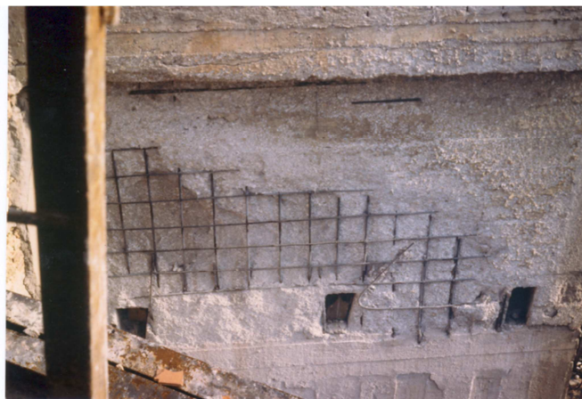
Figura 1. Parede com destacamento do betão após incêndio.
