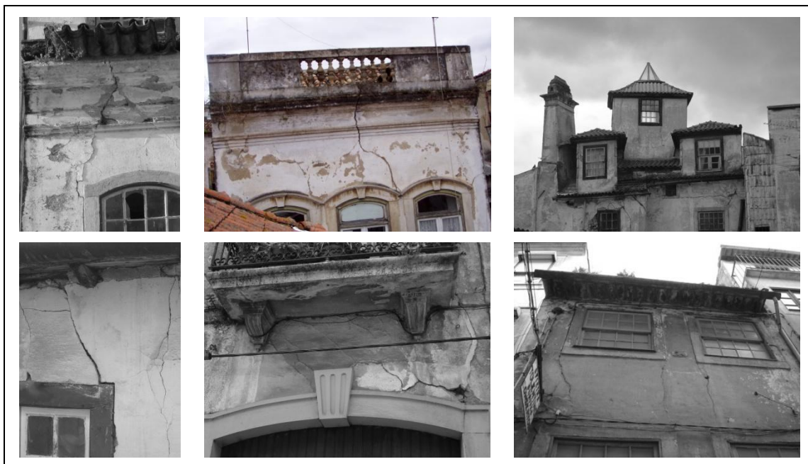
Figura 70. Diversos exemplos de fachadas fissuradas na Baixa de Coimbra.
