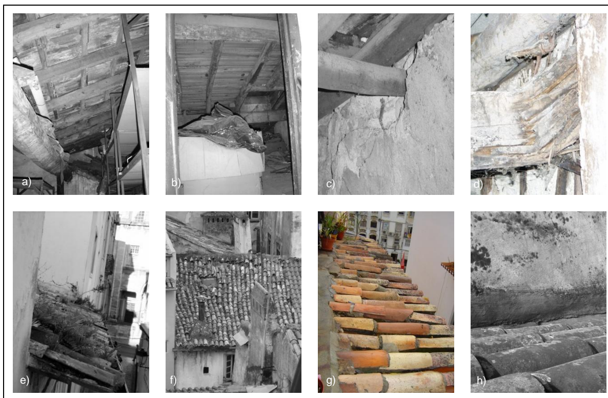
Figura 62. Anomalias em coberturas: a) e b) Humidades; c) Fragilização da ligação da estrutura à parede; d) Fissuração/esmagamento em asnas de madeira; e) Vegetação pioneira; f) Desalinhamento da cobertura, encaixe ou sobreposição deficiente; g) Argamassa em excesso; h) Remates e pontos singulares mal concebidos.
