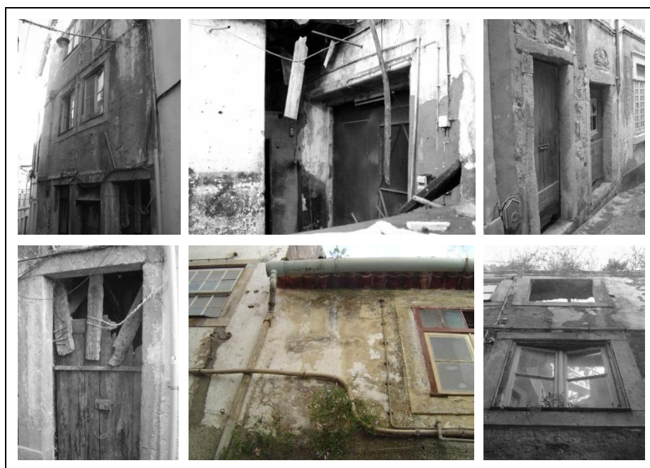
Figura 47. Imagens de edifícios em ruína na Baixa de Coimbra
