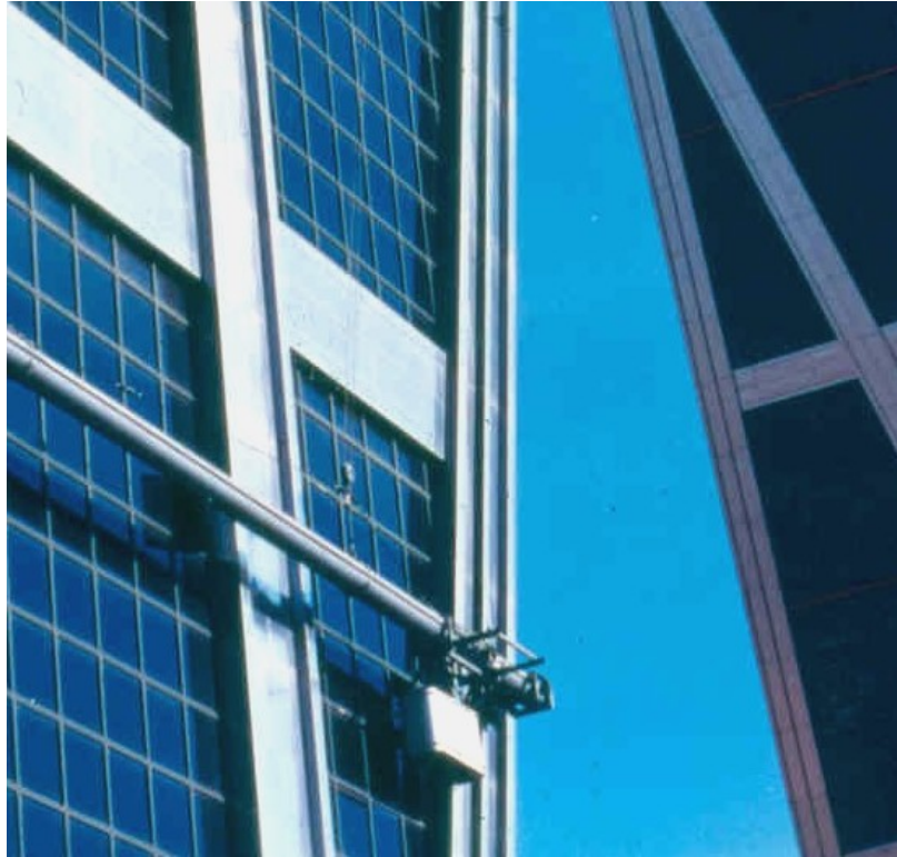
Fig. n.º 45 – As torres Kio, pormenor da estrutura de suporte do bailéu. (FCC)
