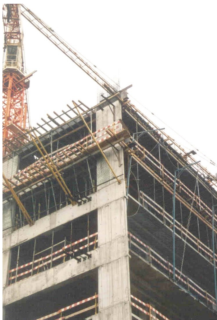
Fig. n.º 36 – As redes de segurança não protegem o cunhal da obra.
