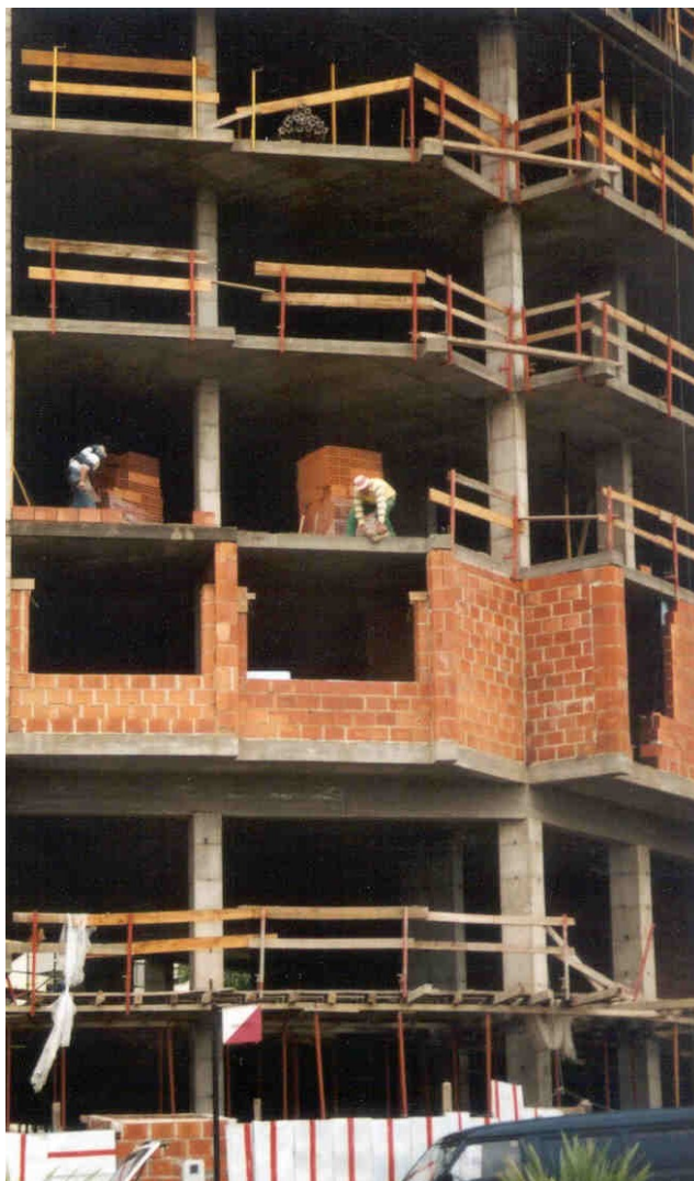
Fig. n.º 38 – A falta de guarda corpos durante a execução da alvenaria exterior.
