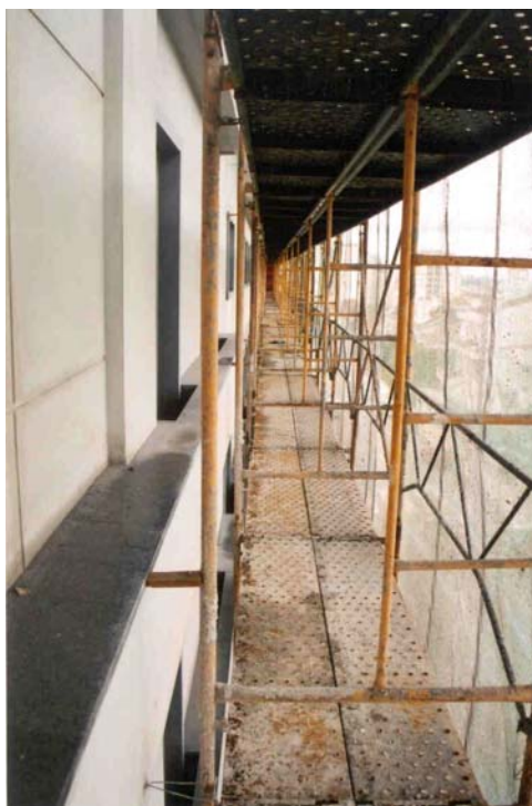
Fig. n.º 31 – Andaimos por módulos, sem guarda cabeças, sem escadas adequadas e com circulação horizontal condicionada.
