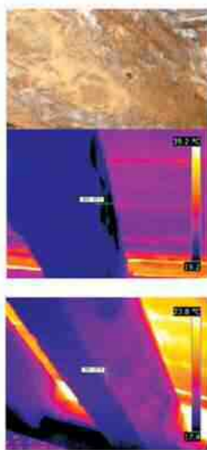
Figura 46 - Através da termografia passiva, por aquecimento natural solar podem ser identificadas zonas com diferente conteúdo de humidade e deterioração parda (retirado de Liñán et al. , 2011).
