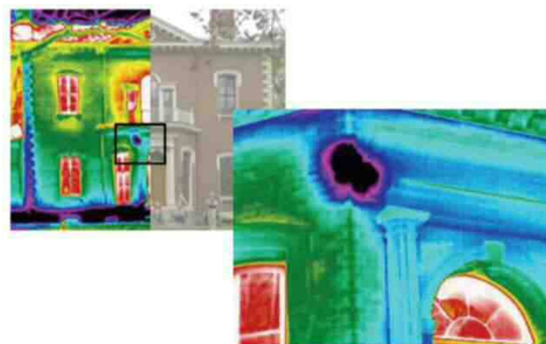
Figura 34 - Detecção de ponto de infiltração através de TIV numa construção histórica no estado do Kentucky. Do lado esquerdo pode ver-se o termograma e do lado direito a fotografia regular. Em baixo a ampliação evidencia um ponto de infiltração de humidade (retirado de Spencer, 2008).
