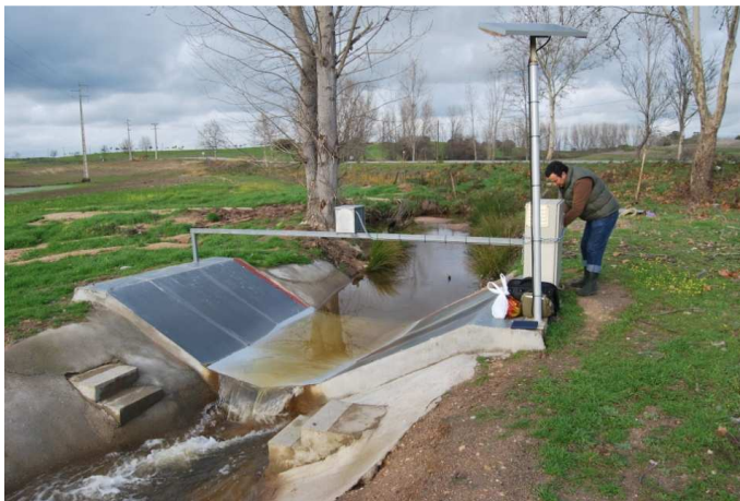
Figura 4: Aspeto do dispositivo experimental instalado na secção de referência da bacia hidrográfica de estudo, localizada no Aproveitamento Hidroagrícola da Campina da Idanha.
