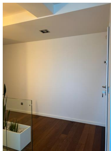
Figura 59 - Hall de entrada, parede a intervir (Fonte: Filipa Nascimento, 2023)
