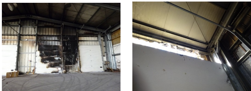
Figuras 7 e 8 – Situação em que ocorreu a entrada de chamas, gases quentes e partículas inflamadas: portão da indústria (figura 7); janela translúcida (figura 8).
