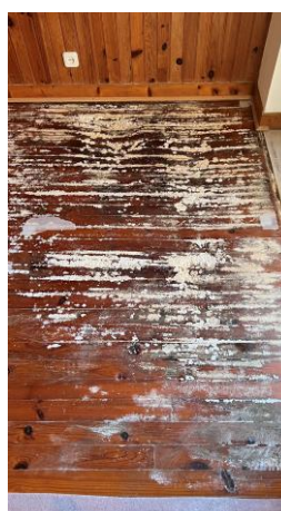
Figura 153- Estado de infiltração do pavimento, P.03_PL; Fonte: Filipa Borges Nascimento.
