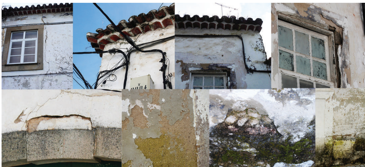
Figura 04.34 - Principais anomalias no exterior do edifício, imagens da autora
