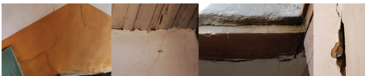
Figura 04.36 - Principais anomalias nas paredes do 1º andar, imagens da autora
