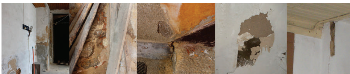
Figura 04.35 - Principais anomalias nas paredes do rés do chão, imagens da autora
