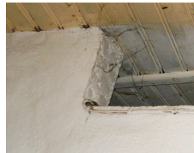
Figura 04.25 - Alvenaria de tijolo, casa de banho do rés do chão, imagem da autora
