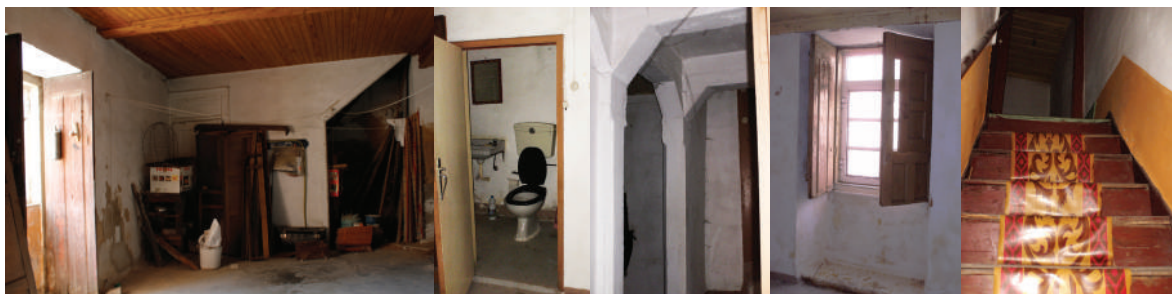
Figura 04.06 - Rés do chão - Garagem, casa de banho, estrutura de betão, janela da Rua dos Chões e escadas, imagens da autora
