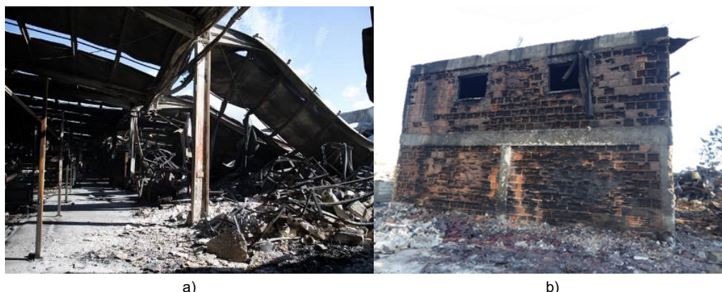
Figura 1: Danos em estruturas – a) colapso dos elementos metálicas que faziam suporte da cobertura e deformação dos elementos verticais; b) elementos em betão armado com sinais de spalling e fissuração – Fonte: [8]
