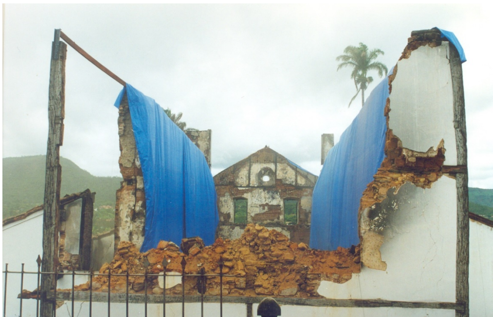
Figura 24: Estrutura da Igreja Matriz de Pirenópolis/GO, após o incêndio de 2002, vista da fachada posterior.
