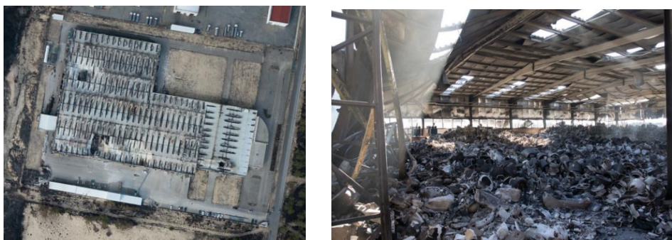
Figuras 3 e 4 – Edifício afetado pela queda de partículas em chamas de um incêndio florestal
