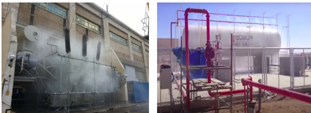
Figuras 3 e 4 - Sistemas do tipo water spray para proteção contra incêndio de um transformador em indústria (à esquerda) e para proteção de cilindro de armazenagem de gás liquefeito de petróleo (à direita). Fonte:
