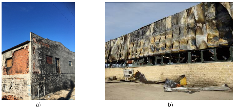
Figura 2: Danos em paredes de fachada – a) Destacamento e Spalling em panos de alvenaria; b) Painéis sandwich PUR com distorção e encurvadura após combustão do núcleo – Fonte: [8]
