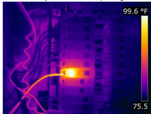
Figura 28 Imagem térmica disjuntor com falta de aperto.
