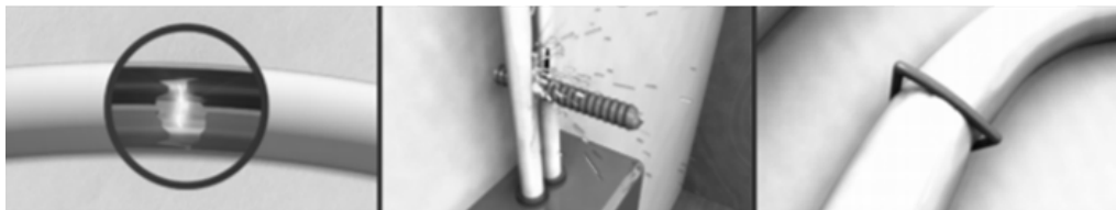
Figura 6 Danos mecânicos à cabos elétricos
