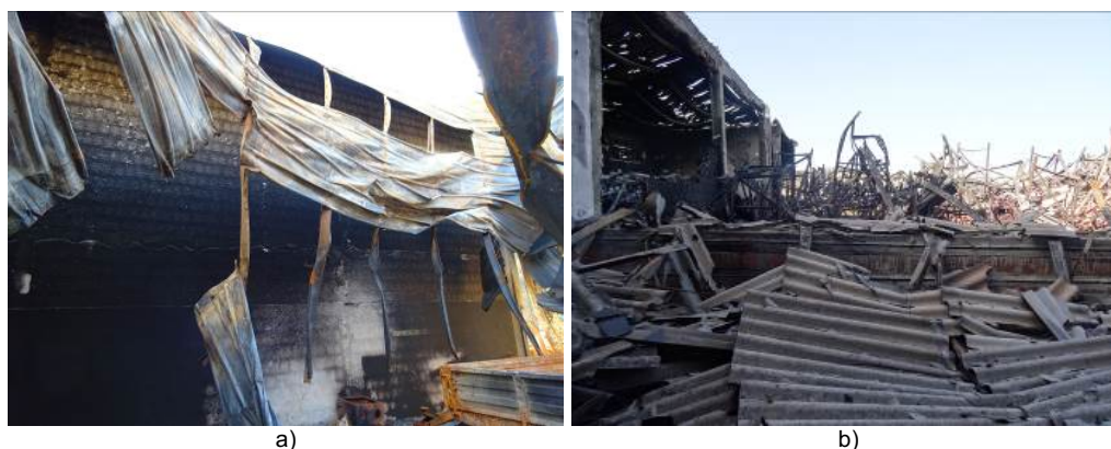
Figura 3: Danos em coberturas – a) Distorção e encurvadura de chapas metálicas; b) Cobertura com painéis de fibrocimento colapsada – Fonte: [8]
