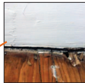
Figura 53 - Degradação do soalho
