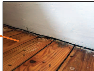
Figura 54 - Desnivelamento de pavimento
