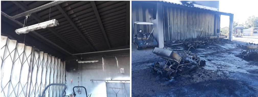
Figura 2: Foto do edifício totalmente destruído pelo fogo
