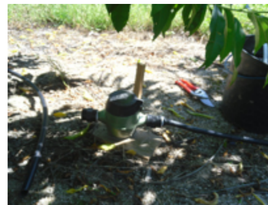
Figura 23 – Medidor volumétrico de caudais instalado numa lateral de um sistema de rega gota-a-gota.
