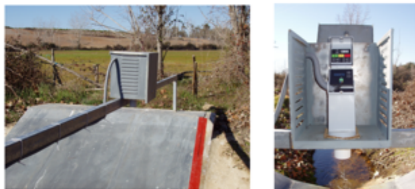
Figura 21 – Sensor de ultra-sons dirigido para a superfície do escoamento numa estrutura hidráulica (descarregador) para medição de caudais.
