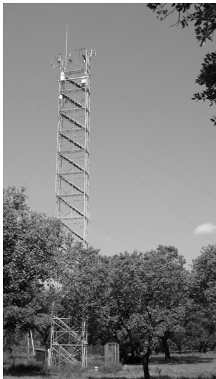
Figura 2.2 - Aspecto da torre (parcela Mitra II-Torre) onde foi instalada a estação meteorológica automática, o sistema de eddy covariance e um conjunto de anemómetros para a medição do perfil vertical da velocidade do vento.
