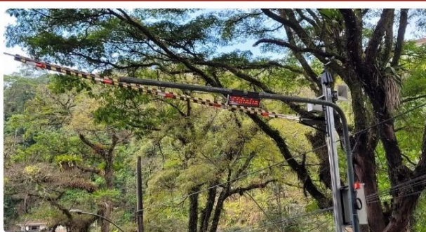
Cancelas automáticas em teste visam impedir a passagem de veículos em áreas inundadas na rua Coronel Veiga, em Petrópolis — Foto: Carlos Miranda/g1
