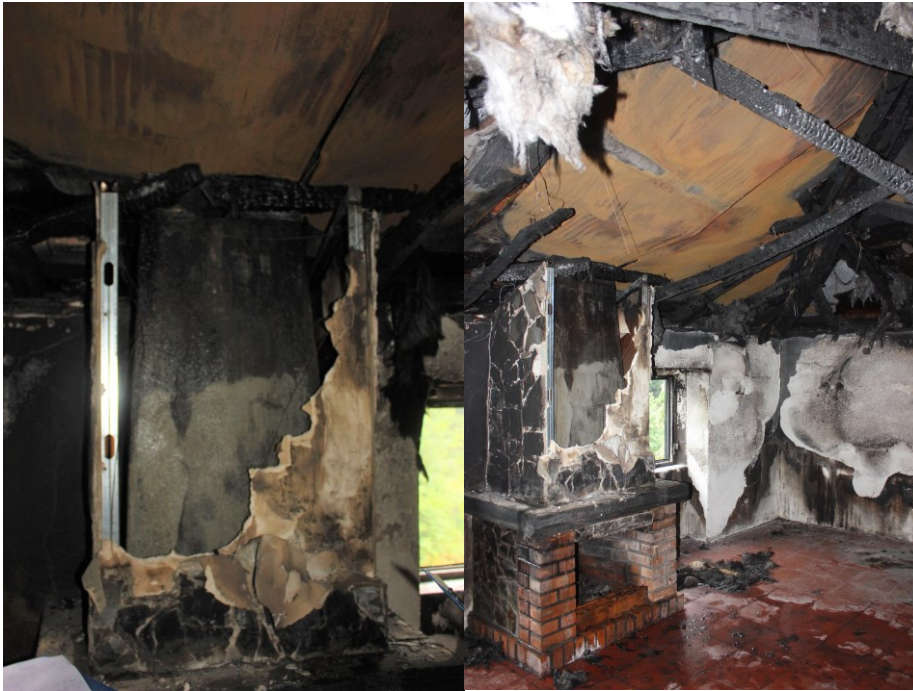
Figura 3: Parede de gesso cartonado, revestida de pedra, e teto de madeira com uma viga dentro da lareira, sem ventilação.
