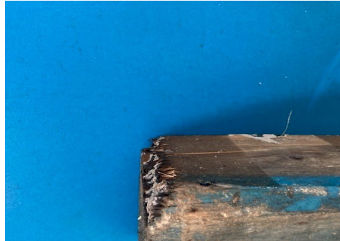
Figura 10: Imagem de uma viga de madeira com zona evidente de pirólise e carbonização.
