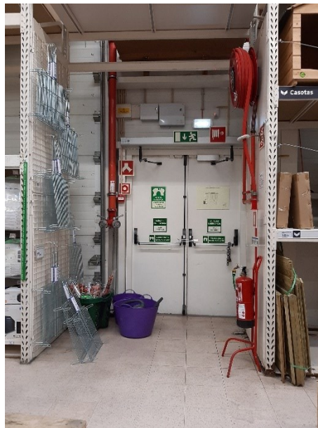
Figura 2: Via de evacuação obstruída, com equipamentos que podem ser derrubados e com excesso de sinalética que pode induzir em erro o ocupante
