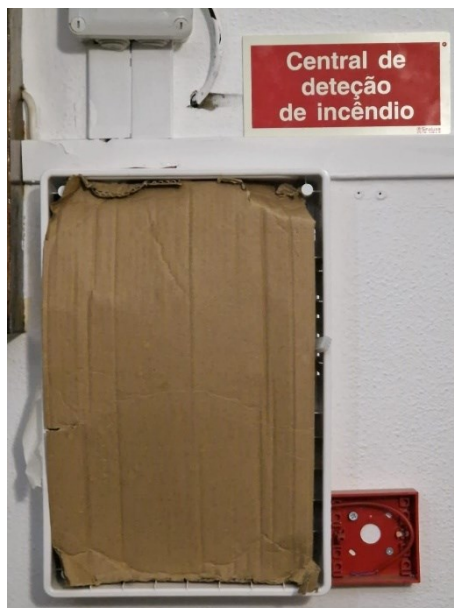
Figura 3: Central de deteção de incêndios inoperacional
