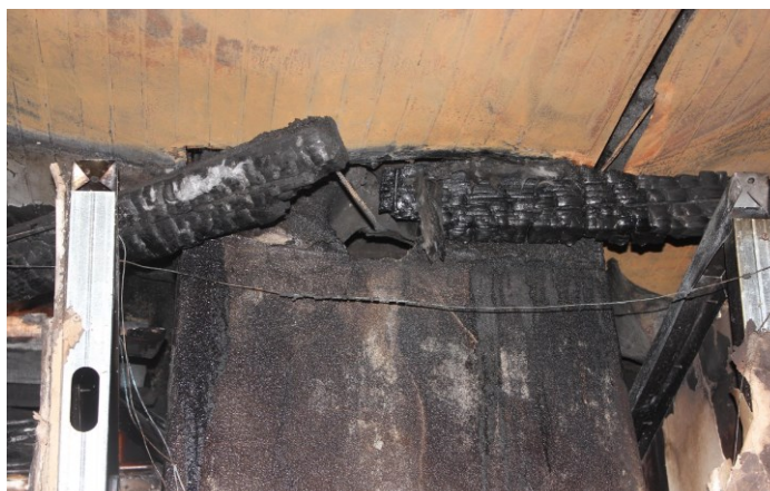
Figura 1: Imagem da chaminé da estrutura da lareira e do teto da casa.
