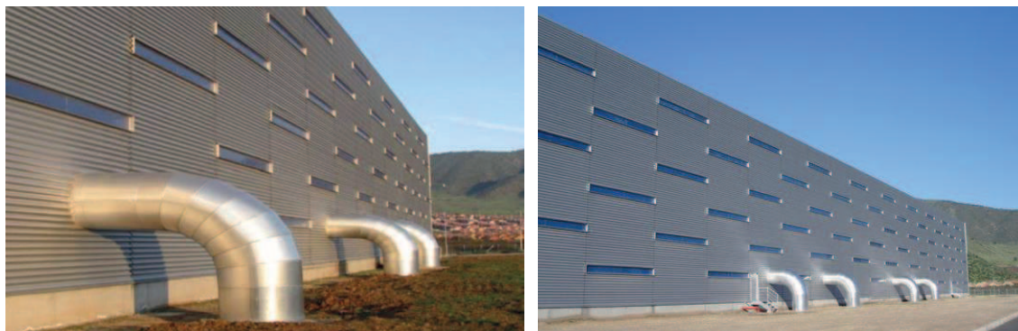
Figura 21 - Permutadores do Centro de Distribuição e Logística FASA, no Chile [31][32]
