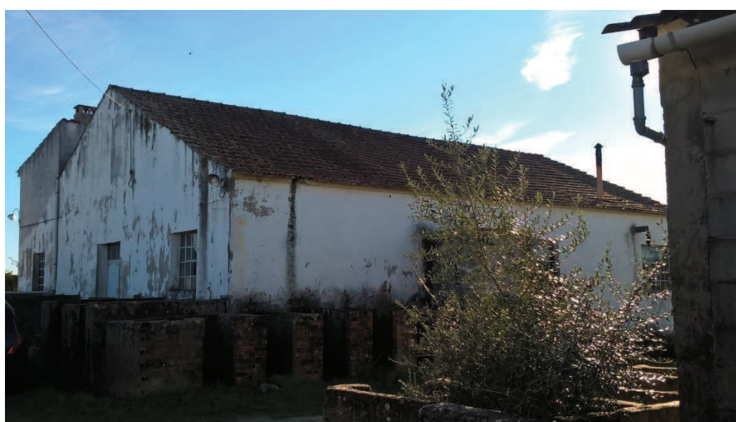
Figura 24 - Lagar de Calvos, deformação da cobertura.
