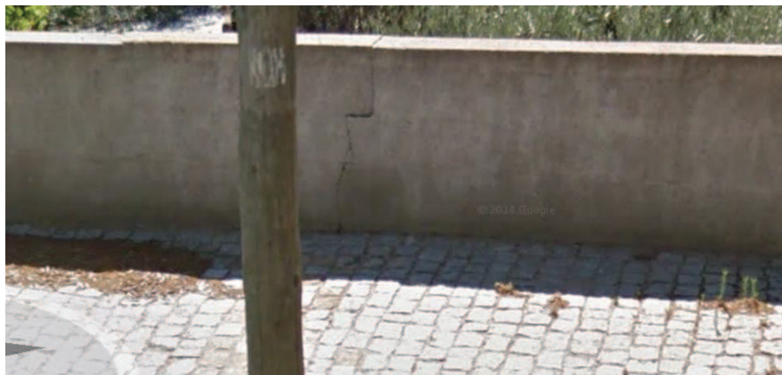
Figura 45 - Fissura central do muro erguido pela Junta de Freguesia, 2014 [22]
