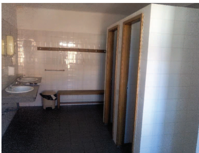
Figura 19 - Instalação sanitária piso 2.
