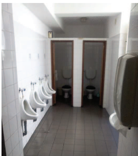
Figura 18 - Instalação sanitária piso 0
