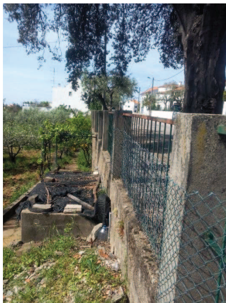
Figura 41 - Desaprumo do muro privado.
