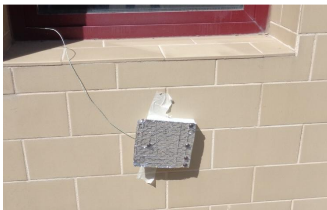
Figura 27-Isolamento colocado sobre o termopar.
