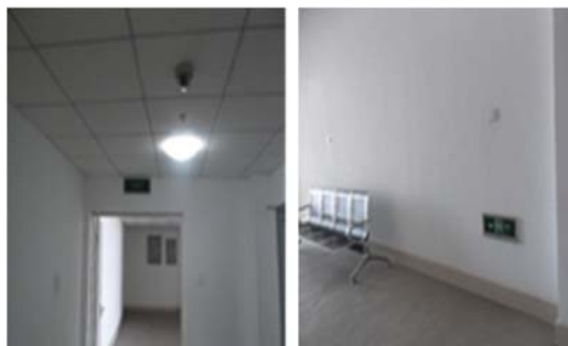
Figura 3 - Disparidade na localização em altura das placas de emergência
