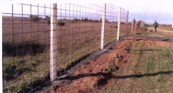
Fig. 2. Cerca fixa chumbada em betão.
