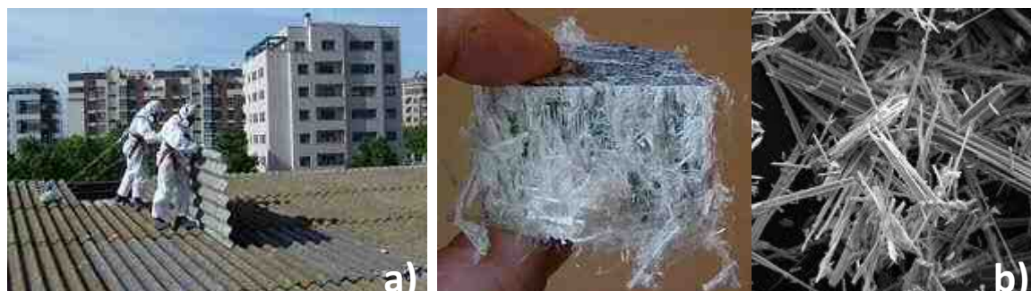
Figura 11 - a) Remoção de painéis em fibrocimento [45] b) Pormenores das fibras de amianto [46] [47]
