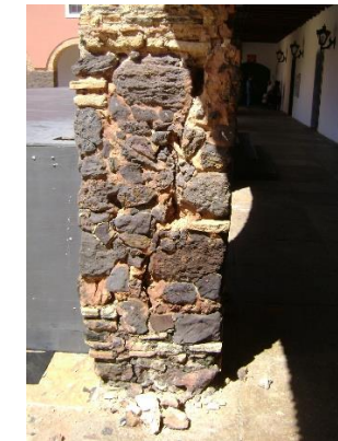
Figura 1: Ruptura das pedras e desagregação de argamassa, (Fonte: Arquivos IPHAN).
