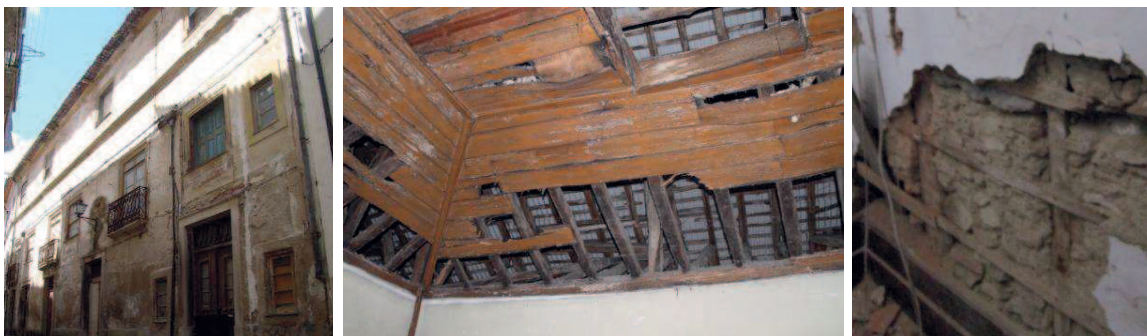
Figura 54 – Edifício da Casa das Talhas considerado em mau estado de conservação.
