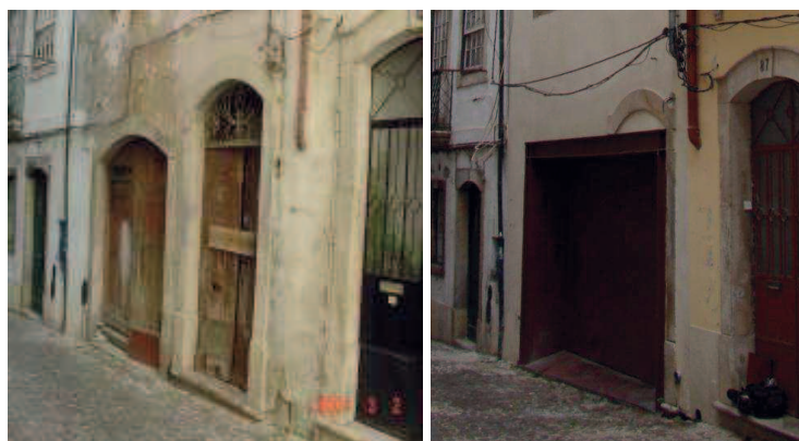
Figura 51 – Imagens de alteração de vãos no edifício nº 83 a 85 [GCH, 2005].
