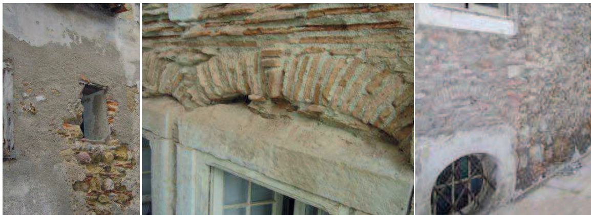
Figura 55 – Exemplos de paredes da fachada posteriores e de empena [GCH, 2010; GHC,2007; Valins, 2013].
