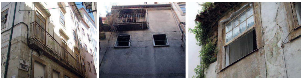
Figura 53 – Exemplos de edifícios em mau estado de conservação.
