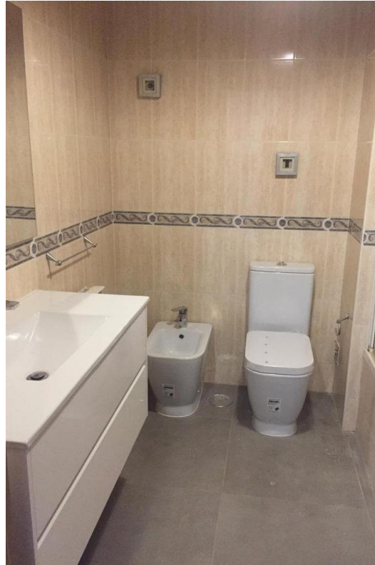
Figura 143- Fotografia dos novos elementos sanitários. Fonte: Interlover's- Home Styling (Projeto GS_LEIRIA).
