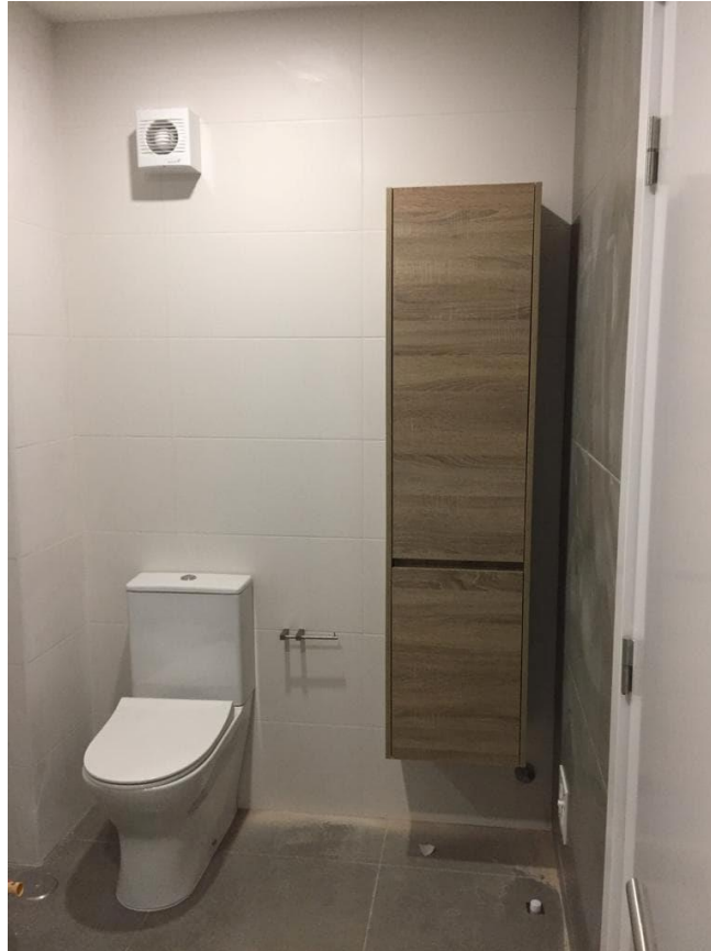
Figura 121- Fotografia durante as montagens da zona da sanita e do móvel coluna.
