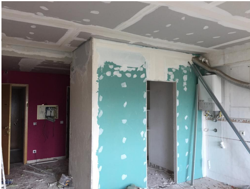
Figura 140- Fotografia dos tetos e paredes que contiveram pladur.
