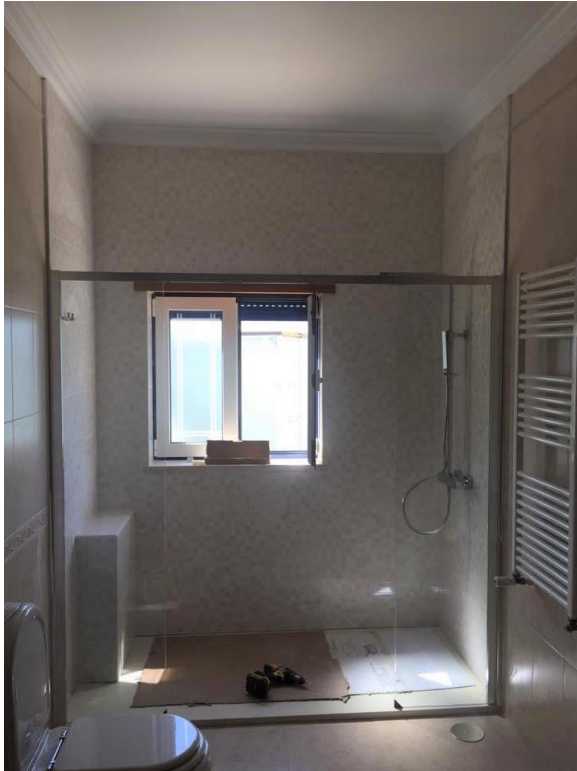
Figura 163 - Fotografia das últimas montagens da intervenção. Fonte: Interlover´s- Home Styling (Projeto DS_ MARINHA GRANDE).
