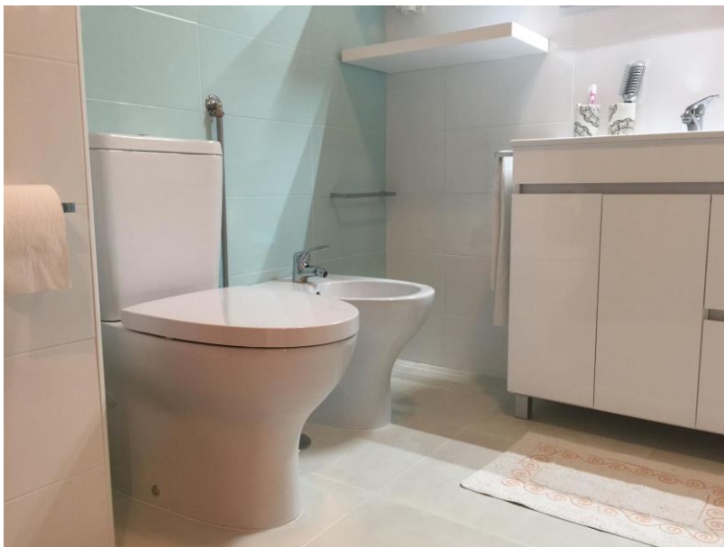
Figura 169- Fotografia das louças Sanitárias.
