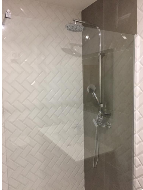
Figura 118- Fotografia do chuveiro aplicado.
