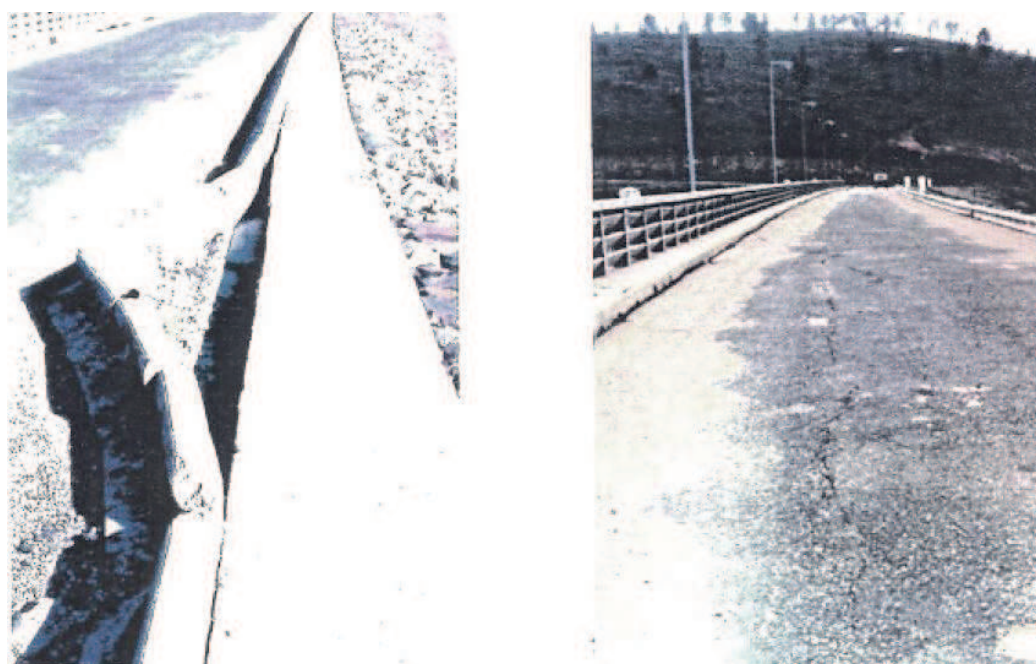
Figura 3-15 - Aspeto das vigas de proteção do passeio de jusante e fendas longitudinais no coroamento (Gomes, A. F. d. S., & Pinto, A. A. V. (1986)).
