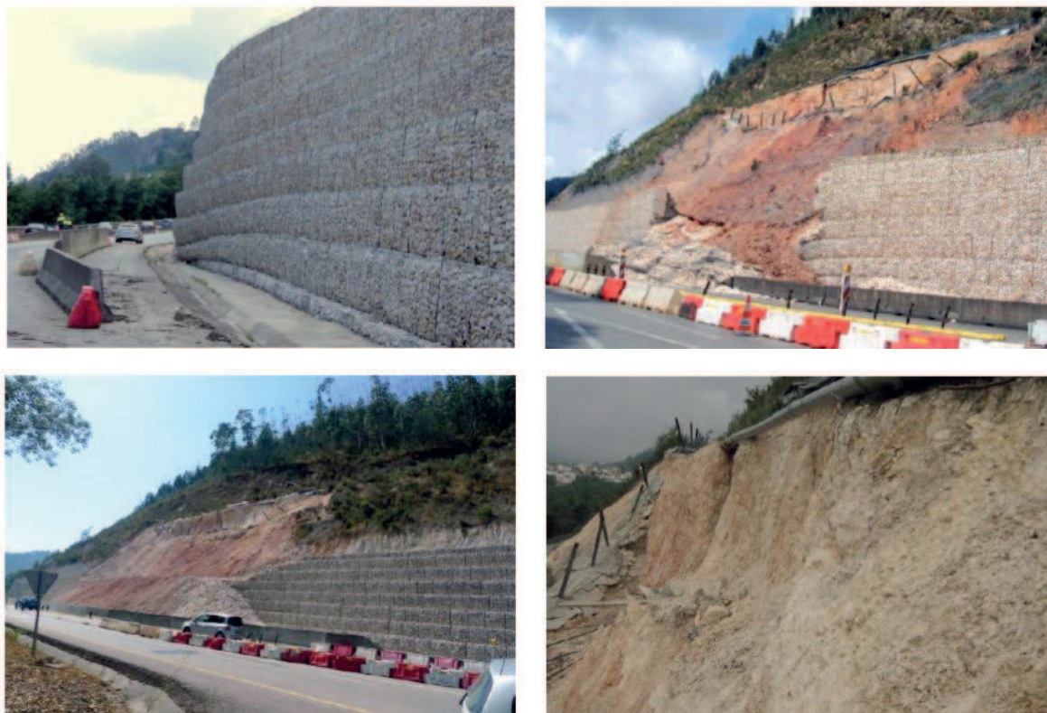
Figura 3-6 - Desmoronamento do talude e respetivo muro de gabiões (Cenor).
