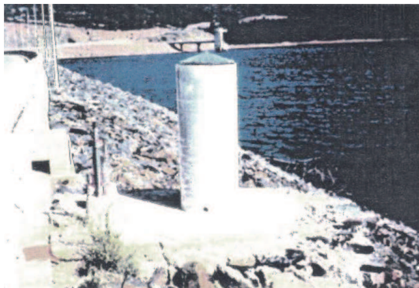
Figura 3-18 - Pilares de observação dos deslocamentos a montante, com problemas de fissuração no maciço de fundação (Gomes, A. F. d. S., & Pinto, A. A. V. (1986)).
