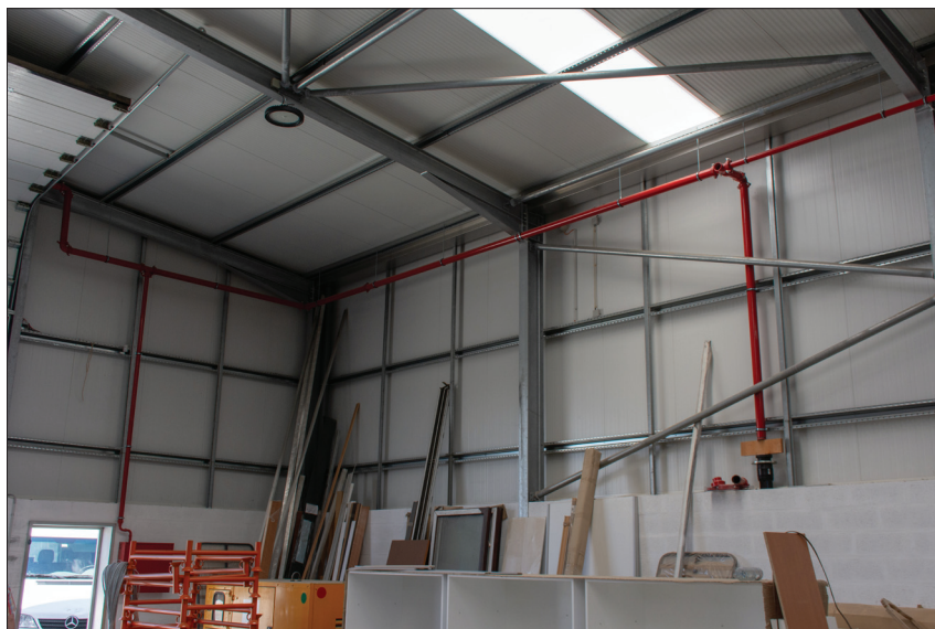
Fot. 8 - Rede de Incêndio Armada por concluir (Fotografia do acervo do projeto, tirada em junho de 2020).
