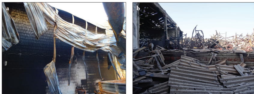
Fot. 3 - Danos em coberturas: a) Distorção e encurvadura de chapas de aço perfilado; b) Colapso de coberturas com placas de fibrocimento (Itecons, 2018).
