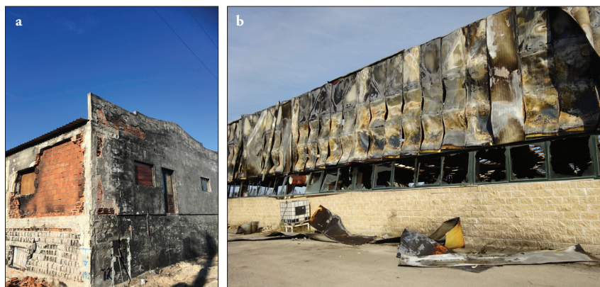
Fot. 2 - Danos em fachadas: a) Destacamento e spalling de paredes de alvenaria; b) Distorção e encurvadura de chapas de aço após a combustão do núcleo de PUR dos painéis sandwich (Itecons, 2018).
