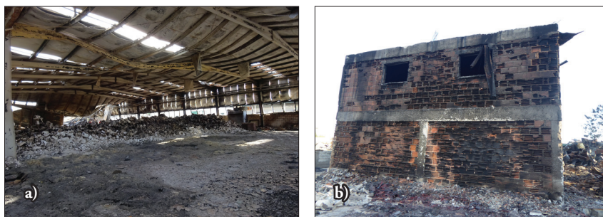
Fot. 1 - Danos em estruturas de edifícios industriais:
