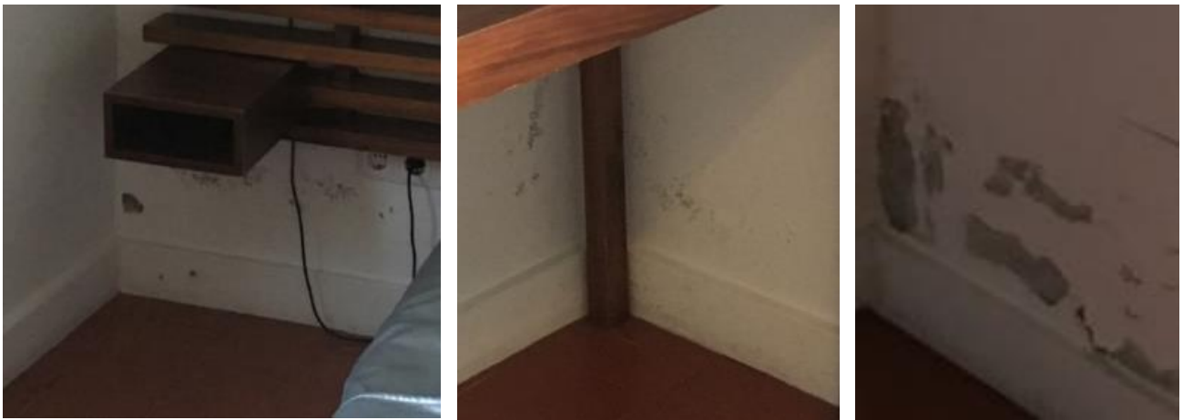
Figura 56 - Fotografias que demonstram os danos causados pela humidade. Fonte: Proprietários do espaço
