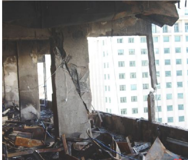
Figura 2. Rotura por corte dos pilares após incêndio (foto cedida por Valdir Silva, Brasil).
