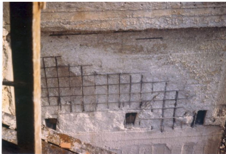
Figura 1. Parede com destacamento do betão após incêndio.
