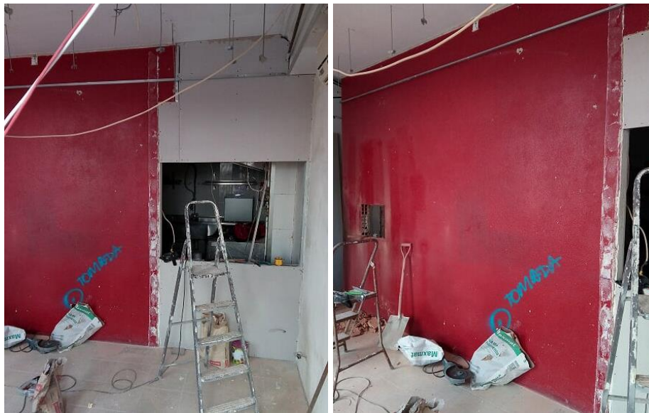
Figura 353 e 354 - Fotografias do espaço em processo de obra, onde é possível ver as aberturas das janelas já feitas, bem como a marcação de uma tomada, e os perfis para aplicação de teto falso
