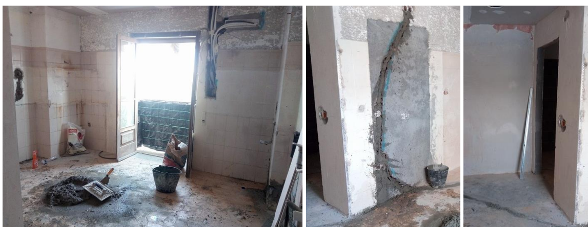
Figura 95, 96 e 97 - Processo de obra da cozinha, onde é possível ver a alteração da localização da porta
