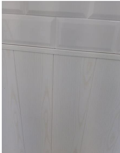
Figura 362 - Pormenor do revestimento cerâmico e do lambril em pvc a imitar a madeira
