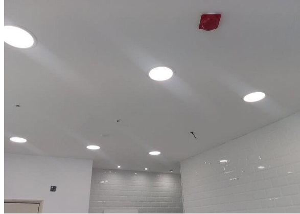
Figura 361 - Teto falso com a iluminação concluída, faltando apenas a colocação da iluminação situada acima do balcão, sendo possível ver as ligações para os mesmos
