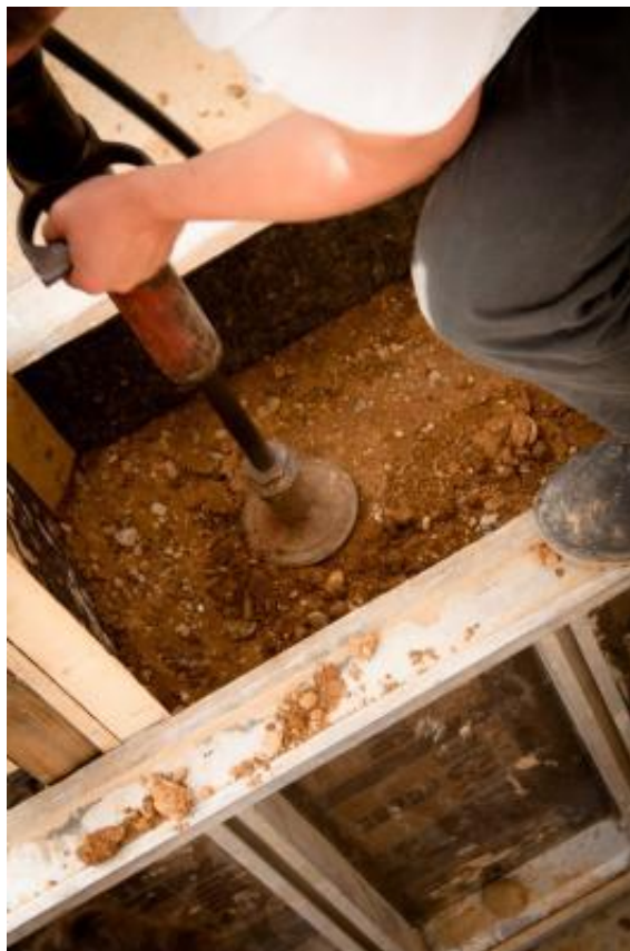
Figura 123 – Preparação da construção de uma parede feita a partir de uma técnica construtiva- A Taipa (imagem) 37
