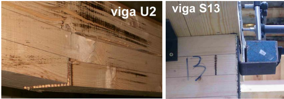
Figura 102 – Imagem da rotura da Viga U2 e do escorregamento no topo da Viga S13.
