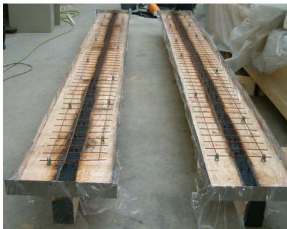
Figura 73 – Vista das vigas mistas com camada intermédia e ligação por parafusos cruzados, antes da betonagem.
