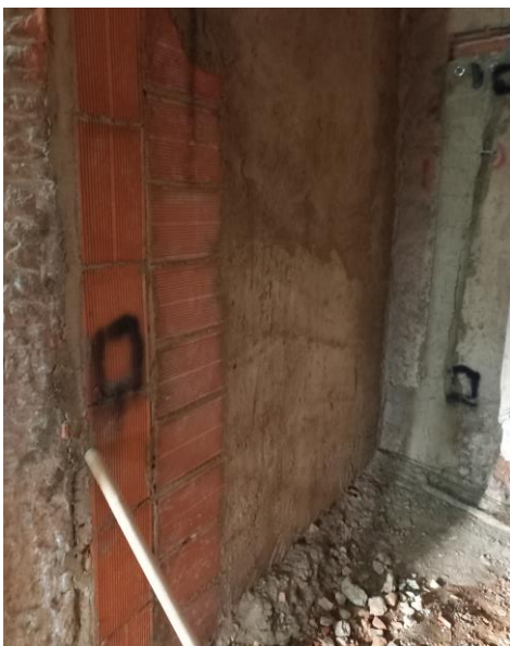
Figura 65 Sinalização de interruptores e tomada para frigorífico. Fonte: Atelier Studio Arte
