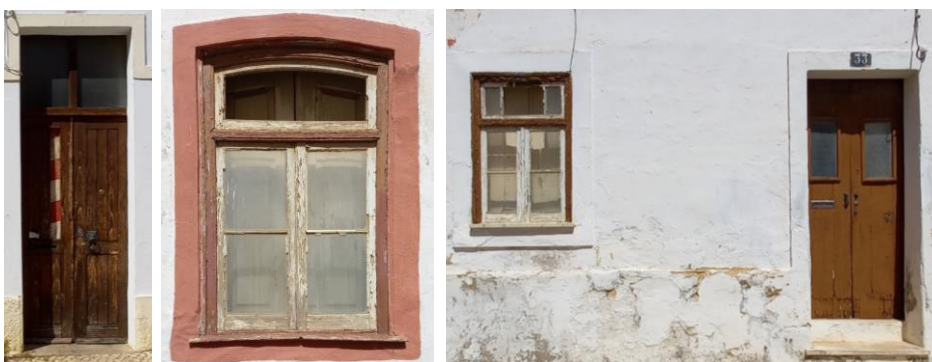
Figura 28 Vãos em madeira degradada. Fonte: Autor
